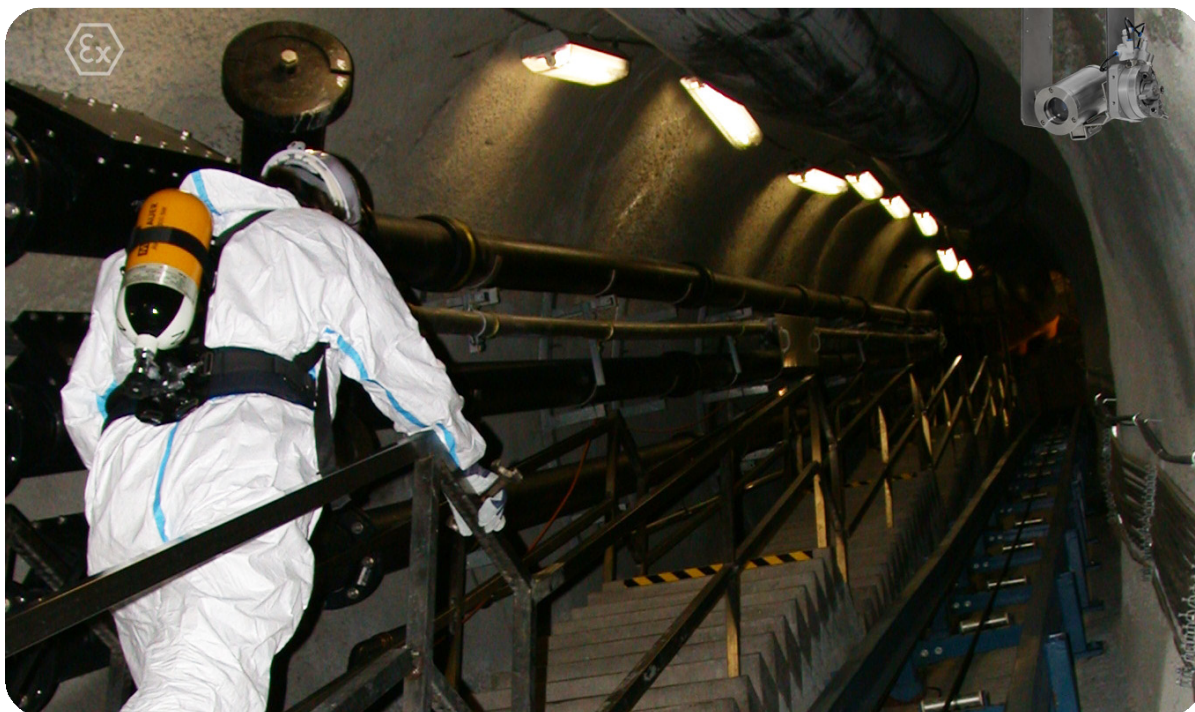
Bild 1: Aufstieg zur Wartungskammer „47a neu“ der Biomasseanlage ABlar - ständige audiovisuelle Messwartenkontrolle
